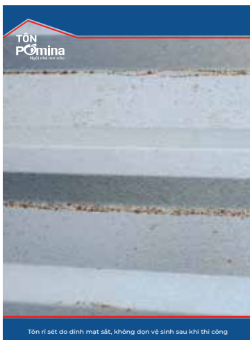
Tôn rỉ sét do dính mặt sắt, không dọn vệ sinh sau khi thi công
