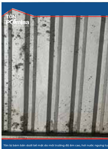
Tôn bị bám bẩn dưới bề mặt do môi trường độ ẩm cao, hơi nước ngưng tụ
